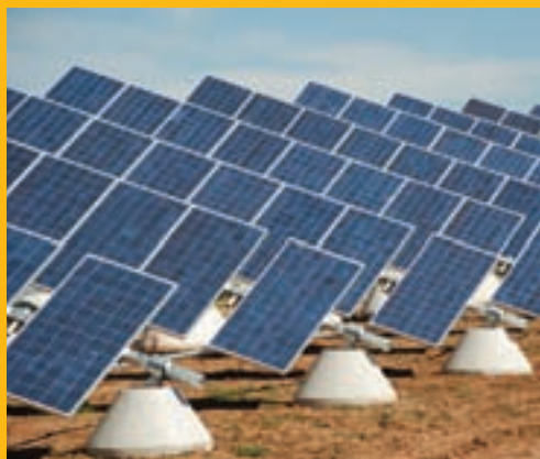
Olivenza Solar Park -18 MW - Spagna
